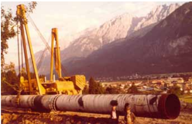
Die typischen gelben Maschinen beim Verlegen der Rohre in der Nähe des Gasthofes „Haidenhof“.
