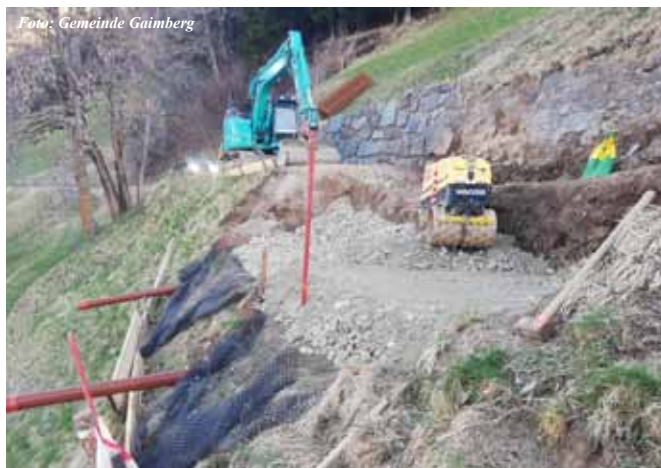
Foto: Gemeinde Gaimberg Die Hangrutschung im Bereich des „Moser-Gossacher Weges“ wurde inzwischen auch bereits saniert.
