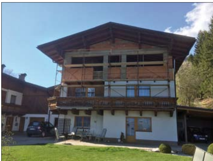
Stefanie Waldner, Oberdorf: Aufstockung des Wohnhauses und Errichtung einer Photovoltaikanlage beim Gebäudebestand.
