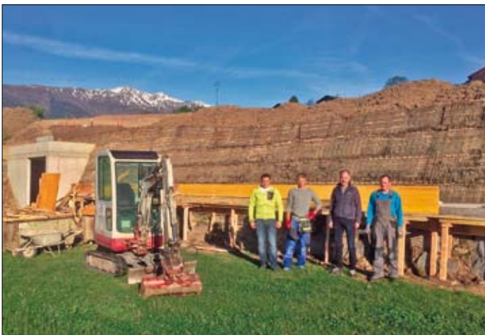
GV Ing. Bernhard Kurzthaler und Bgm. Ing. Reinhold Kollnig mit den Arbeitern der Firma Schader Bau.
