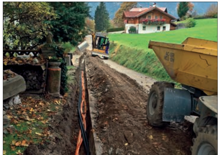
Zufahrtsstraße Haus Egartner: Sorgfältig werden die Leitungen und Rohre in Sand eingebettet.
