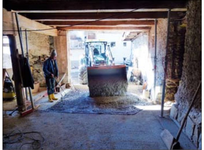
März 2014: Fundamente für Säulen, Vormauerungen für Stützmauern und eine Bodenplatte werden betoniert.
