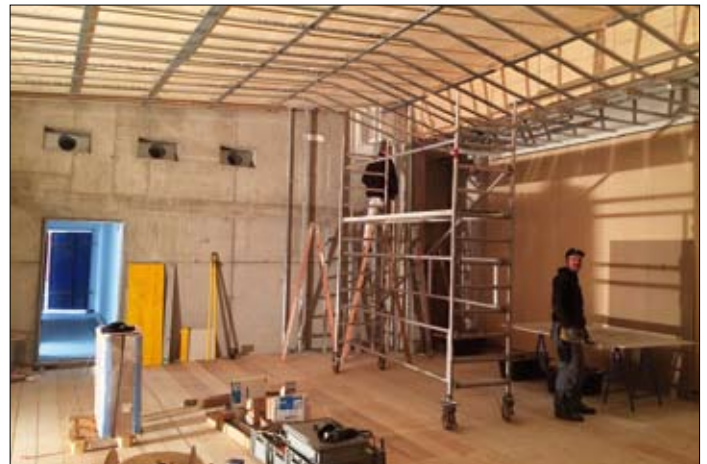
Jänner 2015: Der Innenausbau auf der Bühne beginnt. Die gesamte Technik für Lüftung, Elektrik und Audio wird in und hinter den Wänden eingebaut.
