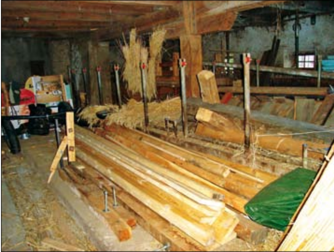
Blick in den vorderen Stall vor dem Ausräumen. Der Stall diente den Vereinen und der Gemeinde als Lagerraum.
