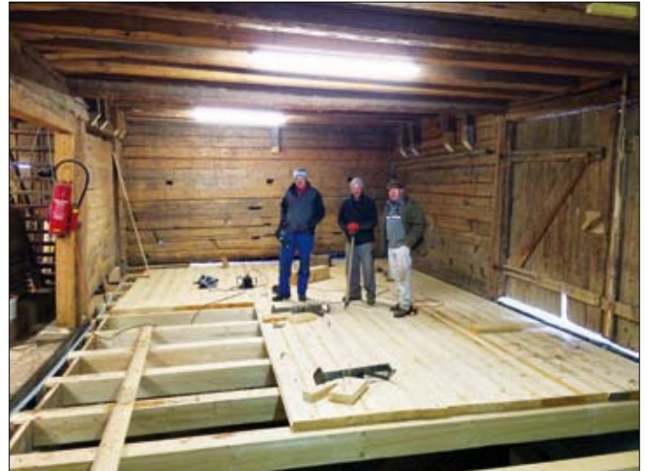
Jänner 2015: In den zwei hinteren ursprünglichen Ställen werden neue Holztrame und ein 6 cm dicker Holzboden montiert.
