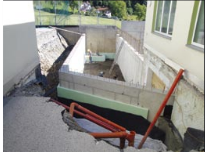
Blick nach Osten zwischen Zentrale und Turnhalle. Im Bild das neue Gerätelager.
