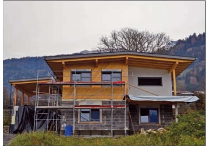
Andreas Großlercher und Johanna Gomig errichten im Mußhauserfeld ein Einfamilienwohnhaus (Baubeginn Mai 2018).
