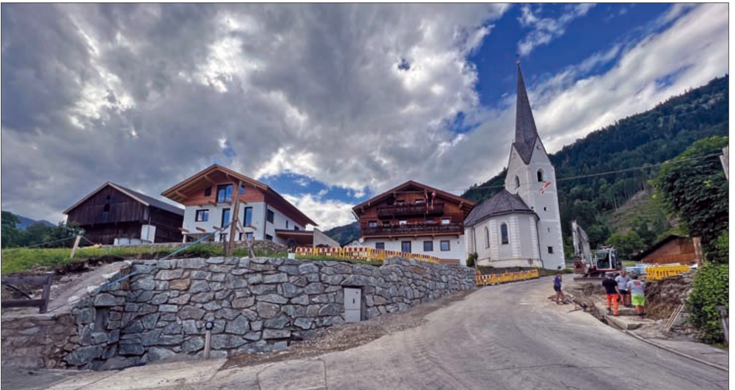
Stand der Bauarbeiten am 5. Juli 2023: Die Natursteinmauer auf der linken Seite ist fertiggestellt. In diesem Bereich wird ein neuer Gehsteig vom Renneweg kommend errichtet. Rechts im Bild wird derzeit die Stützmauer erneuert. Im Bereich der Kirche wird die Landesstraße etwas aufgeweitet.
