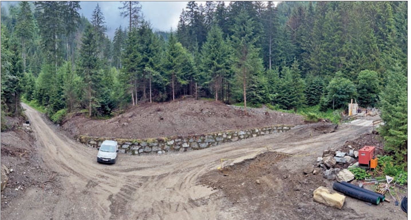
Stand der Bauarbeiten am 13. Juli 2023: Links der Weg ins Helenental, in der Mitte die Begegnungszone mit Stützmauer, rechts die bereits verbreiterte Thaler Brücke und das Kassengebäude.
