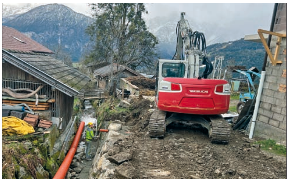
Die in Mitleidenschaft gezogene Bachverbauung zwischen Glanz und Karlen wurde abschnittsweise neu errichtet.
